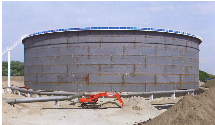
125.000 Kubikmeter, also rund dieselbe Anzahl Badewannenfüllungen, passen in diesen Tankneubau.
